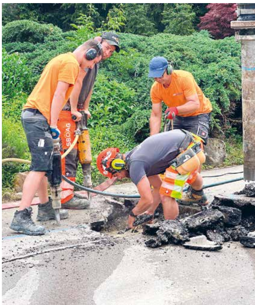
Die Aadorfer Bevölkerung hat nicht immer Verständnis für die vielen Wasserleitungsbrüche.
