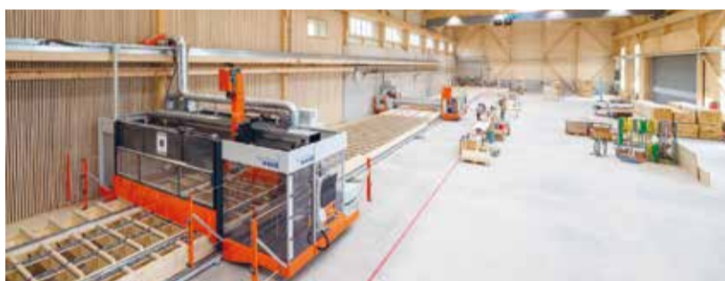
In der Produktionshalle der Firma Isenring Holzbau in Wängi verbindet man ökologische Nachhaltigkeit und gesundes Wohnen.
