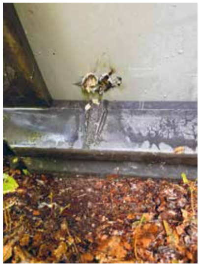
Der Schaden an der mobilen WC-Kabine, der ein glühender Metallpfahl verursachte.
